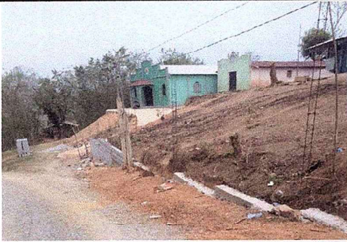
Foto 1: Así se comenzo en la parte donde muro perimetral esta muy dañando
